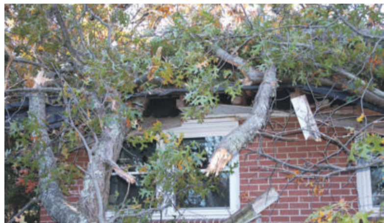
Die meisten Menschen können solche Schäden nicht selbst ausgleichen. In diesem Fall springt eine Wohngebäudeversicherung ein. Foto: DJD/Nürnberger Versicherung/thx
